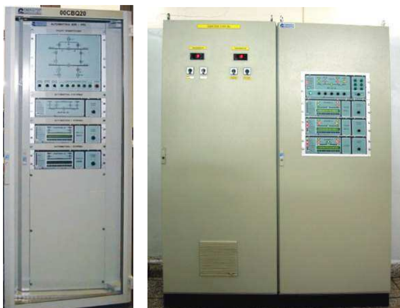
Rys. 6. Szafy z automatyką SZR dla rozdzielni wielowyłącznikowych
