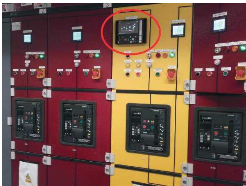
Rys. 7. Zabudowa automatów APZplus w rozdzielni
